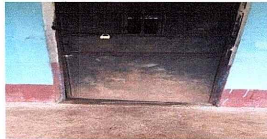
Foto 4: La puerta de la cocina ya se encuentra en mal estado, necesita cambio, para darle seguridad a la misma.
