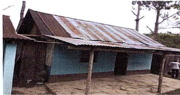
Foto 2: El techo de la cocina ya se encuentra dañada por los vientos que pasa por la aldea como también están dañadas las láminas del corredor de la misma, contando ya con agujeros. Por lo que necesita cambio.
