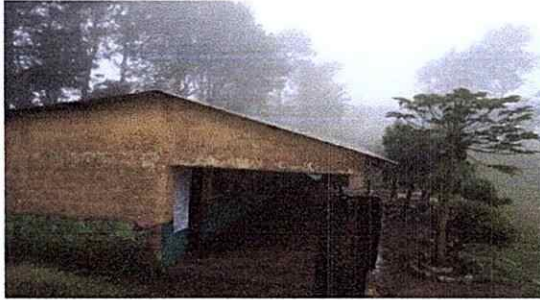
Foto 1: El techo de la Escuela Oficial Rural Mixta necesita cambios al igual que las vigas que ya está continuado por la polilla por el tiempo de uso que ya lleva.
