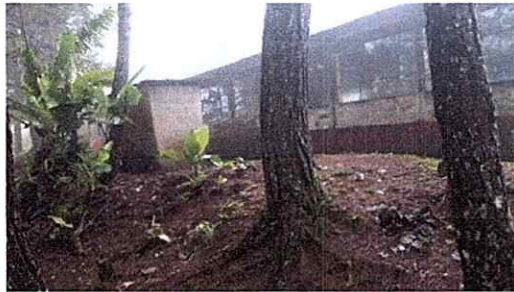
Foto 3: La parte de atrás de la Escuela Oficial Rural Mixta necesita de balcones para darle seguridad a las ventanas de vidrio para que no sean dañadas constantemente.
